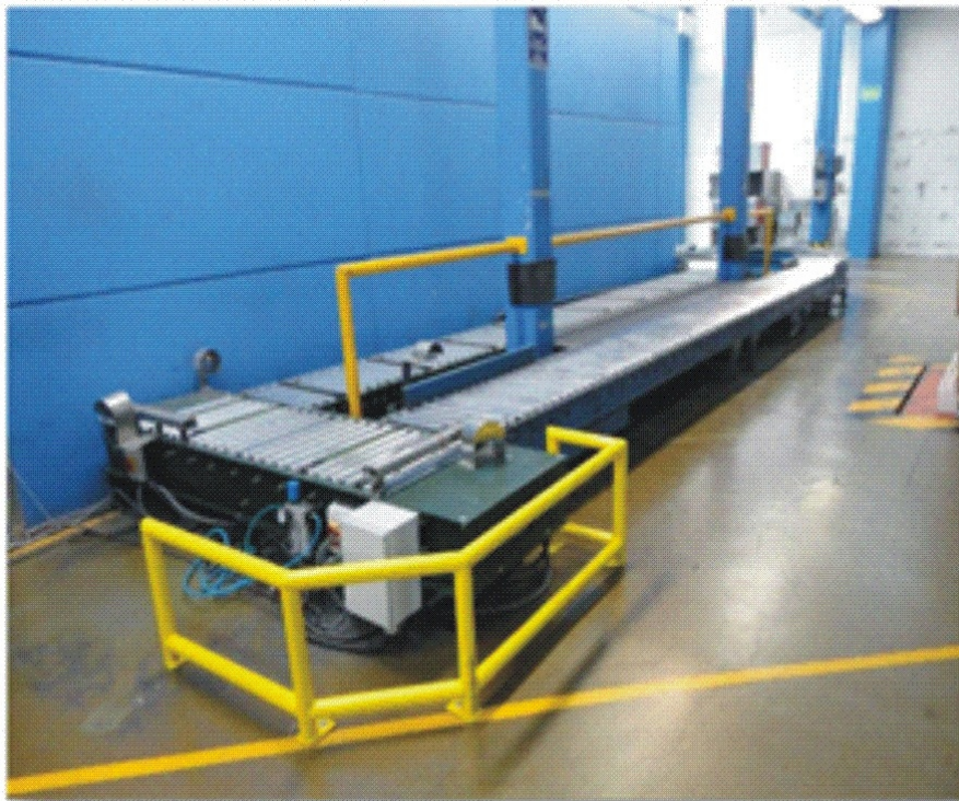
Transferencia sección descarga de producto
