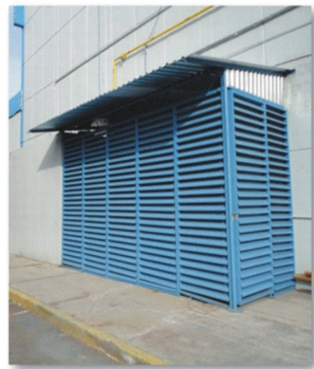
Cuarto de compresores
