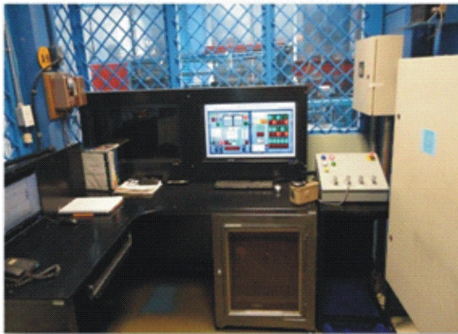
Consola de Control del Irradiador
